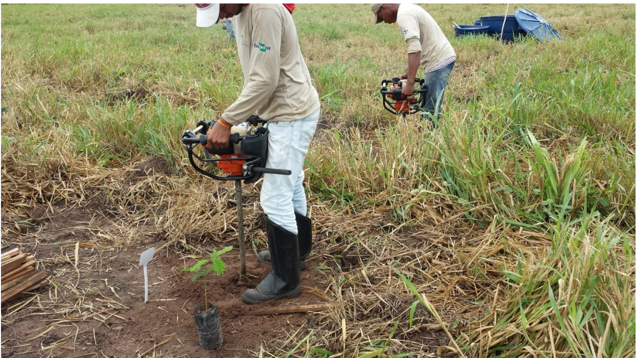
Máquinas em ação no plantio de espécies florestais para reserva legal na Amazônia
